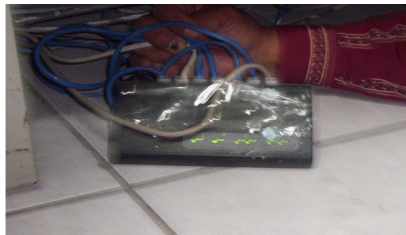
Fig. 3: Switch Marca Encore de 8 Puertos cada uno
