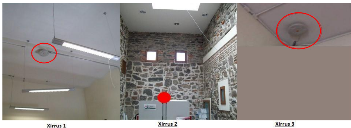
Figura 3.1.2 Antigua posición de las antenas Xirrus
