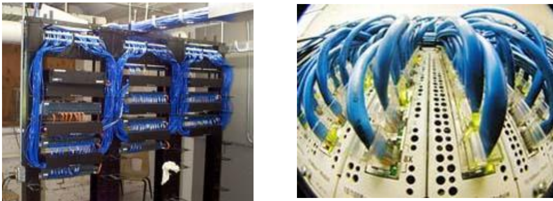
Figura 15 cableado de backbone
