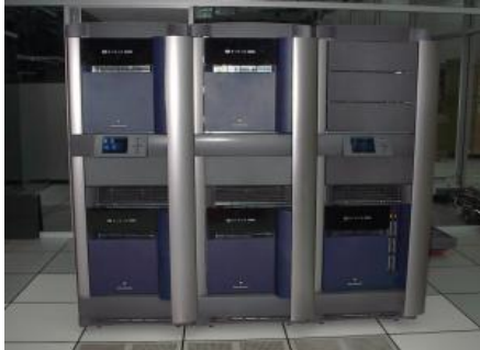
Fig. 1.2a Origin 2000 instalada en 1997 por SGI.
